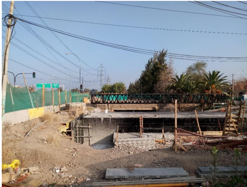
Fotografía 2. Trabajos en la zona del Zanjón de la Aguada (Calle Club Hípico y Avenida Isabel Riquelme).
